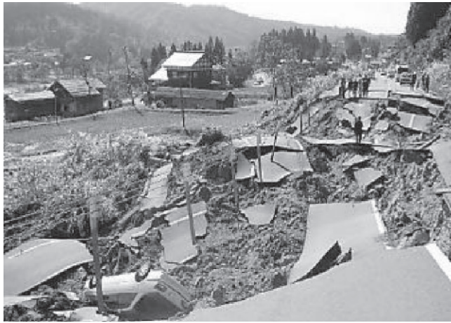
新潟県中越地震により崩壊した国道17号 国土交通省北陸地方整備局道路部提供
